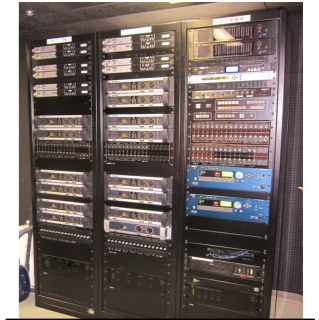
アンプラック架(アンプ室)
