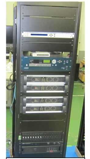
パワーアンプ架(サブ変電室前)
